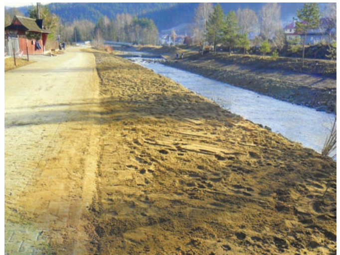
Wykonanie drogi wraz z umocnieniem brzegu potoku Muszynka w Powroźniku. FOT. ARCH. PGK
