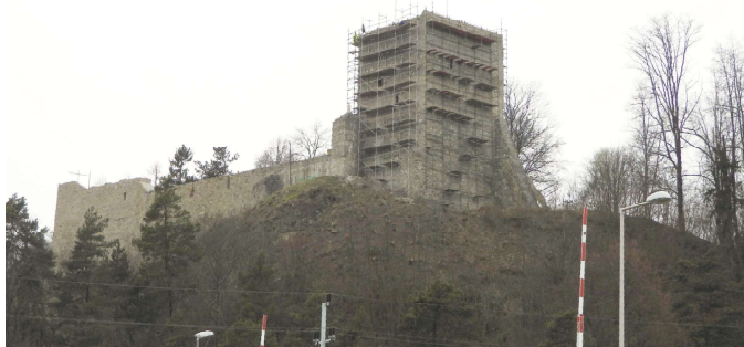
Ruiny zamku w Muszynie podczas prac budowlanych marzec 2023 r. FOT. ARCH. UMIGU MUSZYNA
