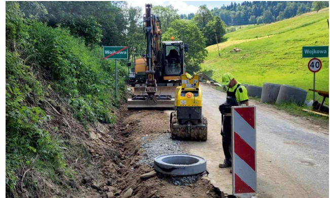
Prace budową przy sieci kanalizacji sanitarnej w Wojkowej FOT. ARCH. UMIGU MUSZYNA
