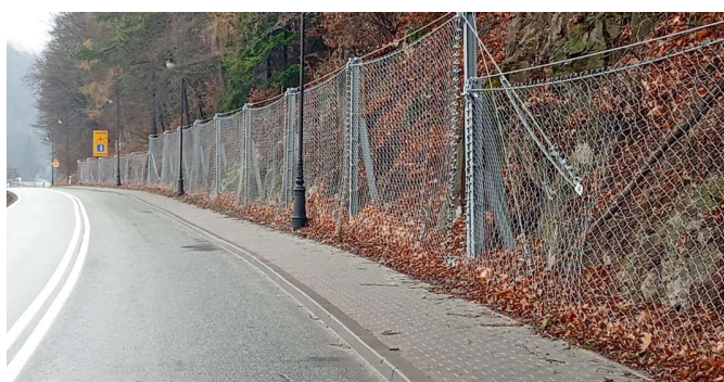
Siatka zabezpieczająca drogę - ul. Lipowa FOT. ARCH. UMIGU MUSZYNA
