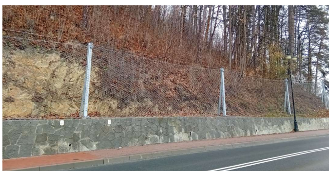
Siatka zabezpieczająca drogę - ul. Basztowa FOT. ARCH. UMIGU MUSZYNA
