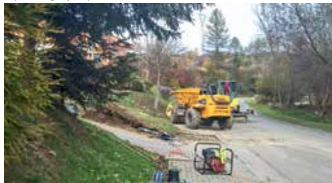
Budowa sieci wodociągowej w Złockiem - projekt w trakcie realizacji wartość zadania: 945 732 zł. FOT. ARCH. UMIGU MUSZYNA
