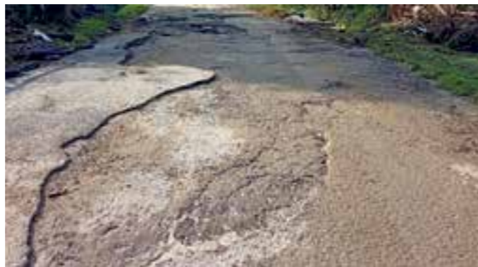
Droga w Wojkowej zniszczona w nawałnicach FOT. ARCH. UMiGU MUSZYNA
