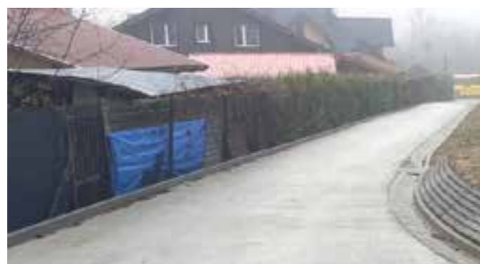
Szczawnik - droga wewnętrzna po remoncie wartość zadania: 177 256 zł. FOT. ARCH. UMIGU MUSZYNA
