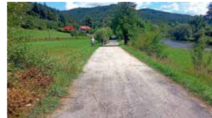
Muszyna - droga na Majdan przed remontem FOT. ARCH. UMIGU MUSZYNA
