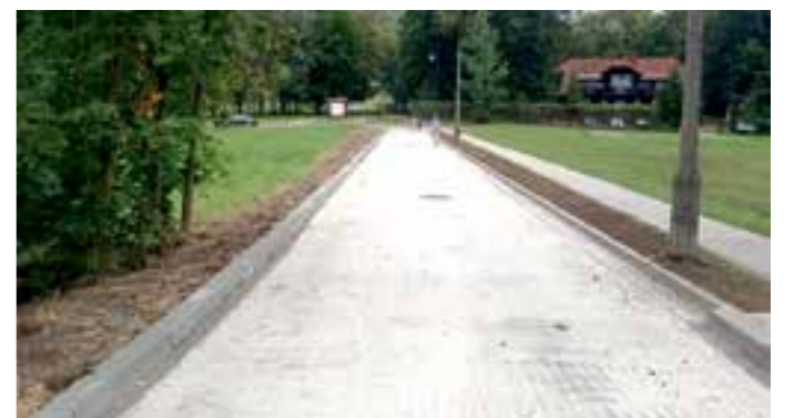
Muszyna ul. Zielona (boczna) po modernizacji wartość zadania: 115 374 zł. FOT. ARCH. UMIGU MUSZYNA
