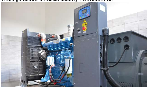
Nowy agregat prądowłczy FOT.ARCH. PGK
