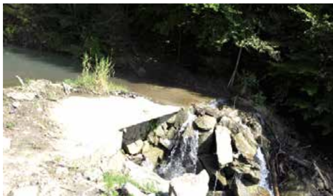
Ujęcie wody „Szczawnik” przed realizacją zadania FOT. PGK MUSZYNA
