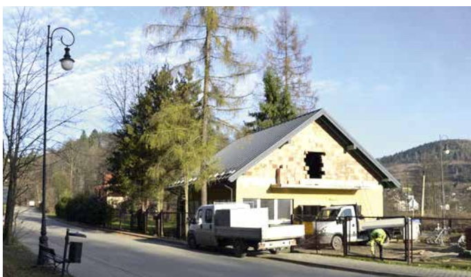
Prace przy przepompowni ścieków przy ul. Lipowej w Muszynie FOT. PGK MUSZYNA
