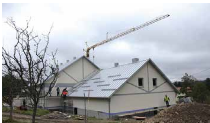
Stacja uzdatniania wody Jasieńczyk FOT. PGK MUSZYNA
